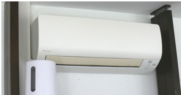
Luft-Wärmeübertrager mit Ventilator, Luft/Luft-Wärmepumpe
