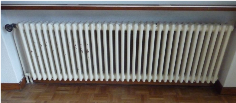
Radiator mit massiven Kühlrippen, früher üblich bei hohen Vorlauftemperaturen
